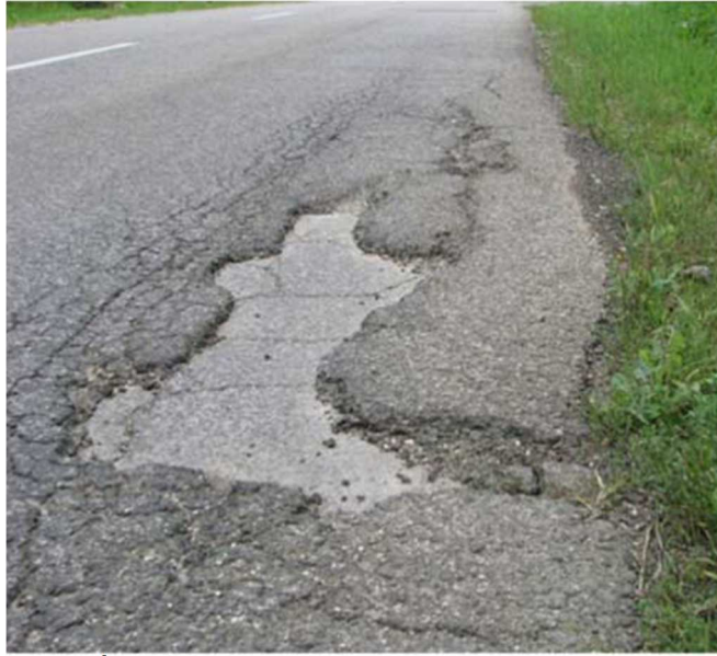
Új kopóréteg elválása a régi burkolattól
