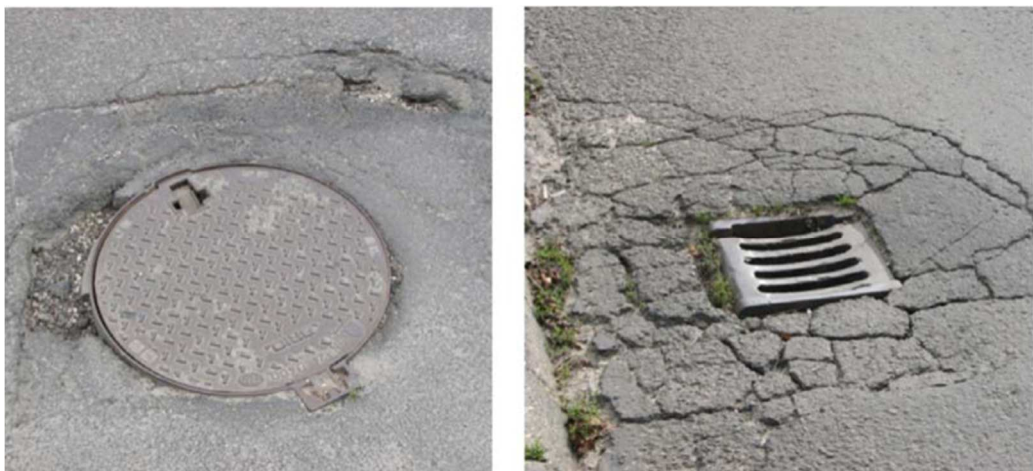
Közmű szerelvények csatlakozási hibái az aszfaltburkolaton
