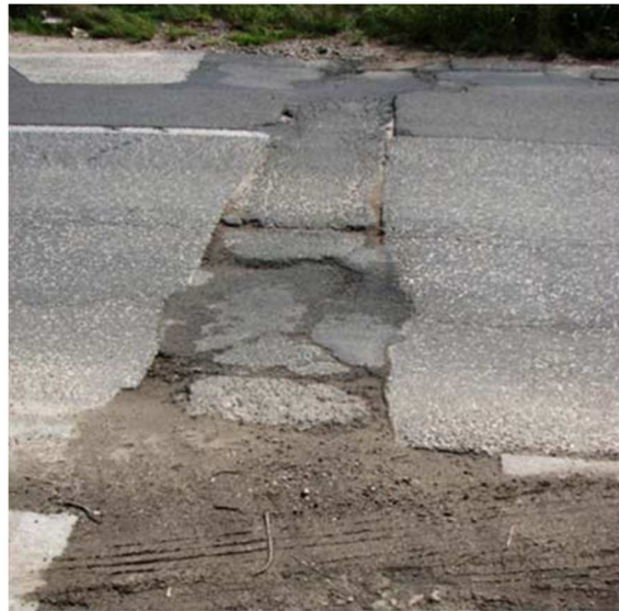
Szakszerűtlen helyreállítás közműépítés után
