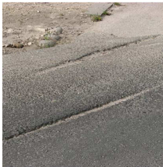
Kopóréteg mechanikai sérülése
